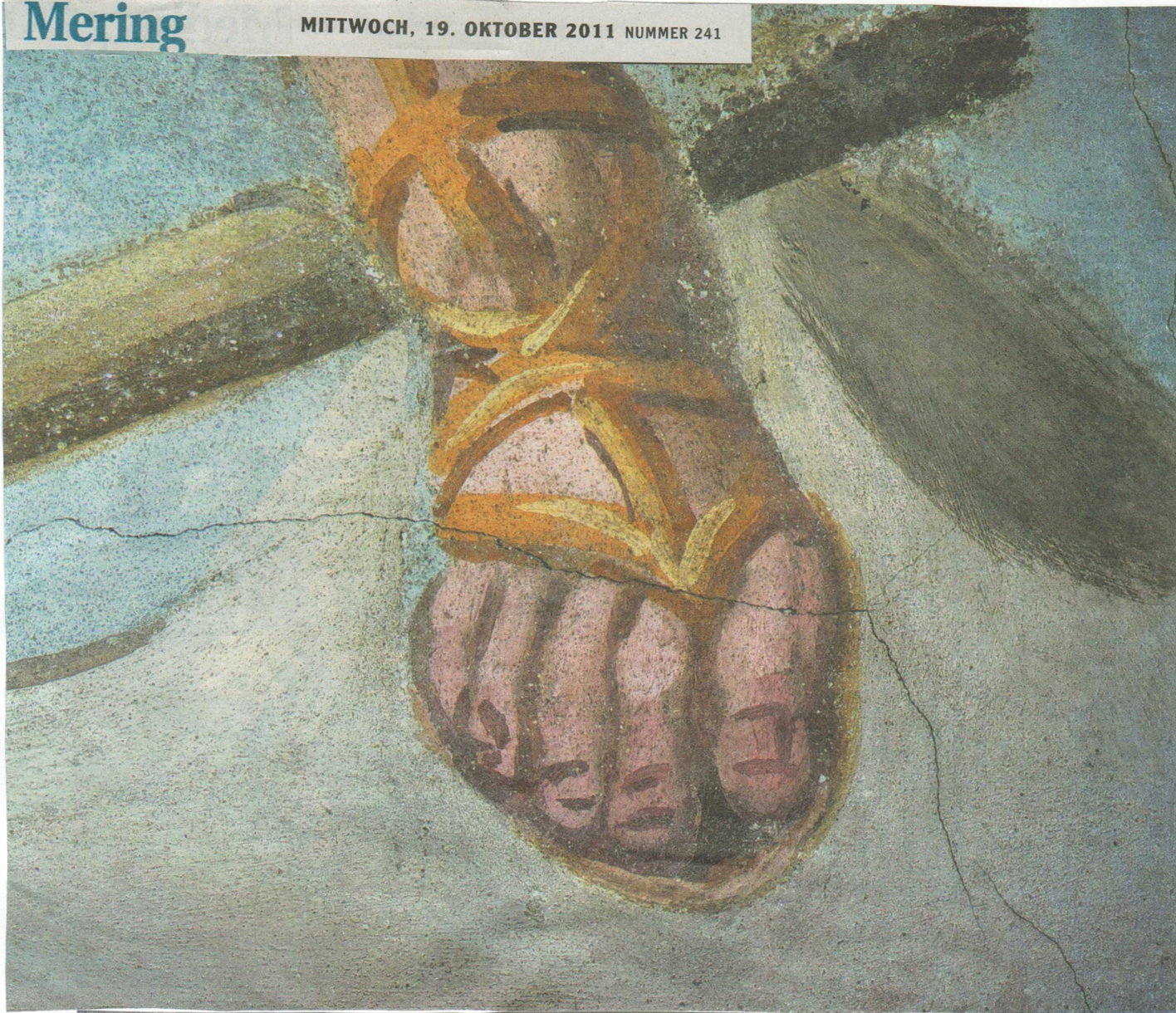
Risse in Deckengemälden machen deutlich, wie massiv die Schäden im Dach sind. Mittlerweile droht Einsturzgefahr in der Meringer Pfarrkirche Sankt Michael.
