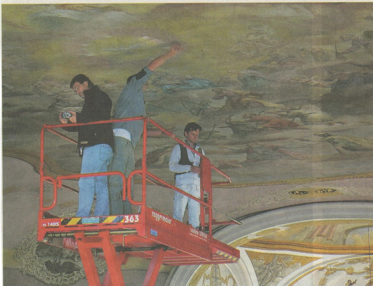
Von einer Hebebühne aus beurteilten Statik-Fachleute den Zustand des Kirchengewölbes, bei dem die Gefahr besteht, dass der Dachstuhl darauf lastet. Die Pfarrkirche St. Michael muss deshalb gesperrt werden. Foto: Maria Driever
