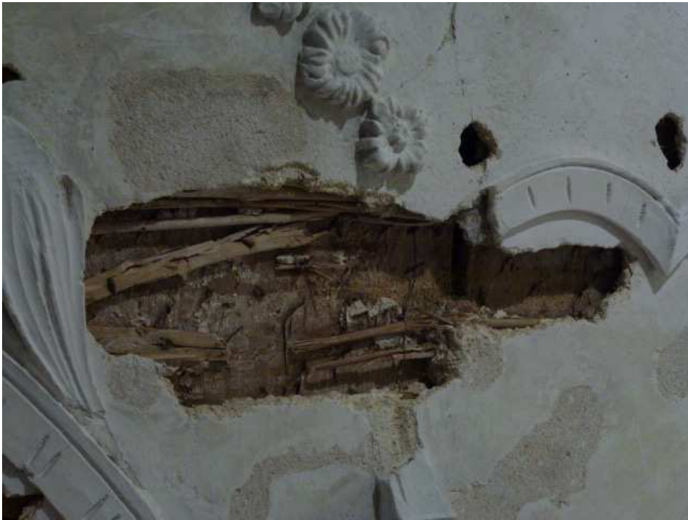
Abb. 2.1: Fehlende bzw. zerstörte Putzträger
