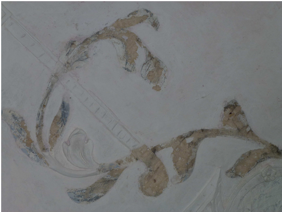
Abb. 4.2: Auf glatten Flächen stuckiert, ohne ausreichende Haftung!
